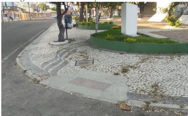
Figura 9 – Rebaixe da calçada com inconformidades
