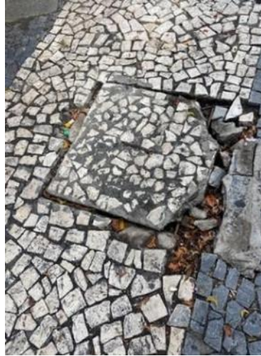
Figura 10 - Tapa de caixa de inspeção danificada
