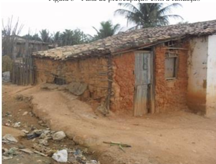
Figura 3 - Falta de preocupação com a fundação
